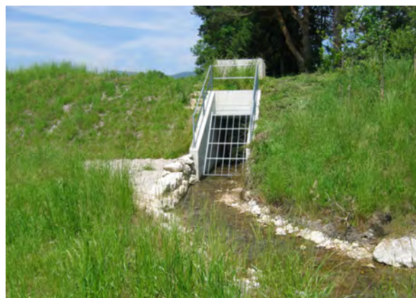
Illustration 25 Entrée de canalisation sécurisée par une grille
